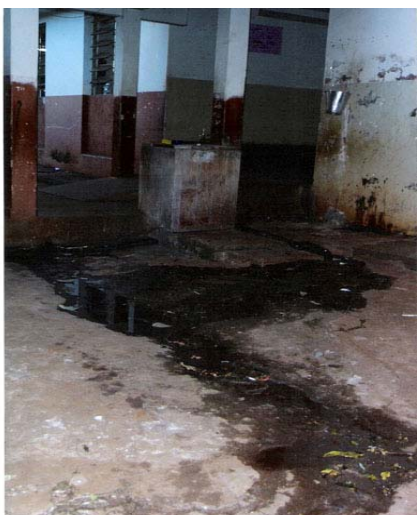
Figura 4 - Foto do pátio da Escola onde se vê a água correndo fora dos canos do esgoto
